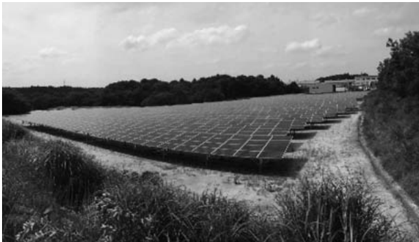
加美町にある孫沢発電所
